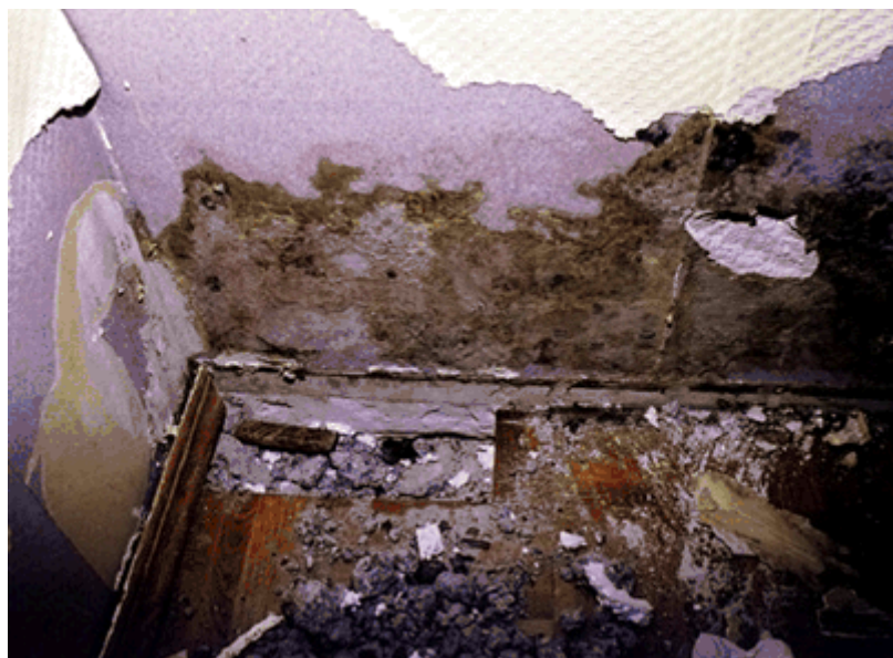
Bild 5: Schimmelpilzbefall nach einem Leitungswasserschaden.
